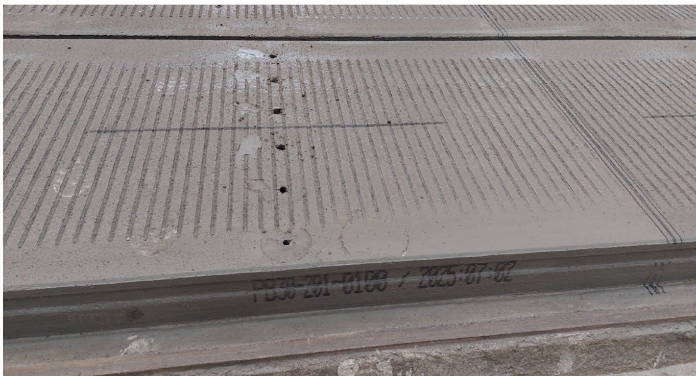
Placa alveolar pretensada con marcas y orificios de drenaje justo después del hormigonado
